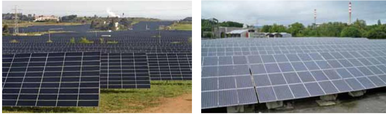
Photo 1 : Installations fixes au sol
